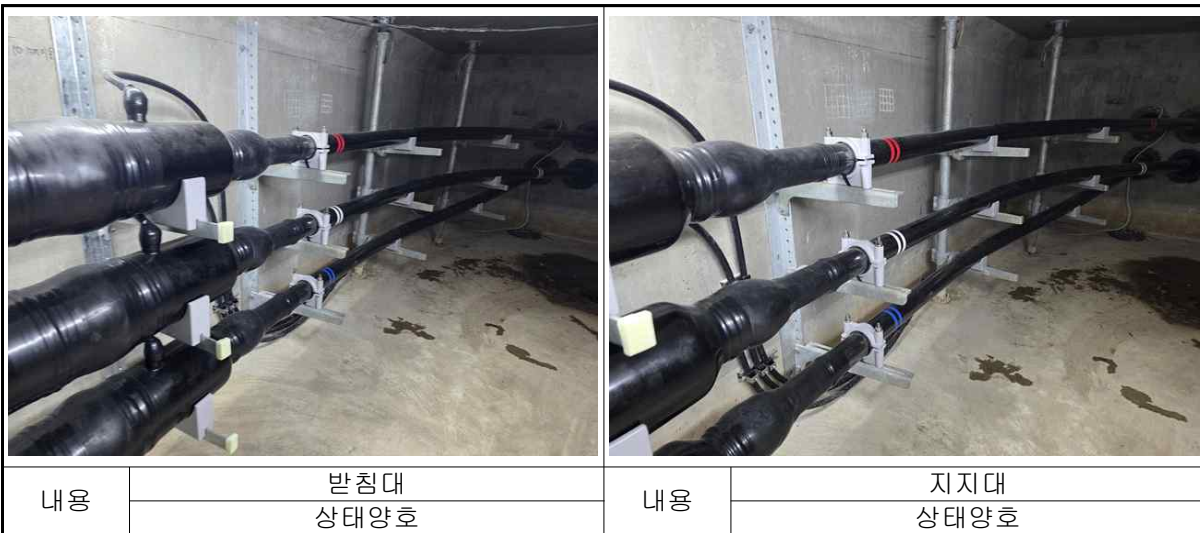
【사진 1.12】 부속 및 부대설비 현황
