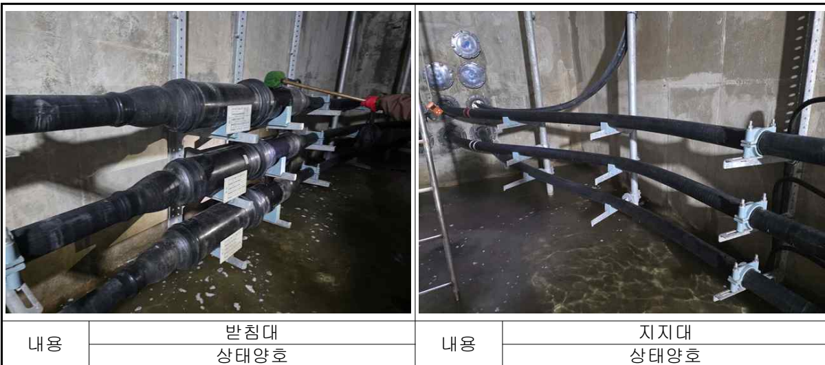
【사진 1.24】 부속 및 부대설비 현황
