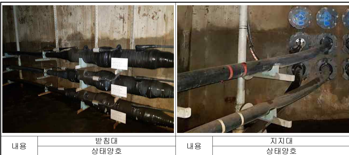
【사진 1.36】 부속 및 부대설비 현황
